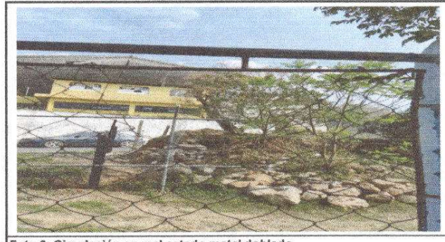
Foto 6: Circulación en mal estado metal doblado.
