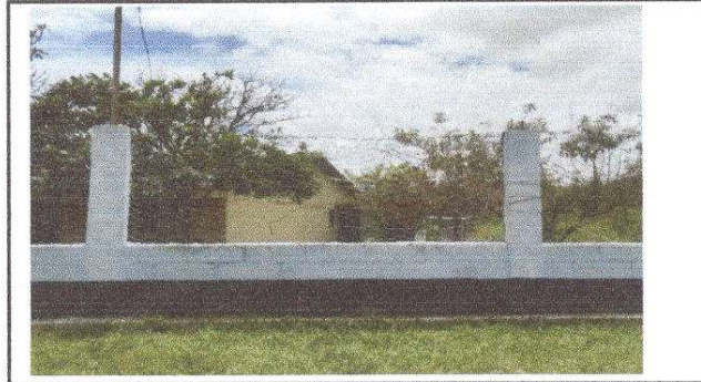
Foto 4: Circulación en mal estado malla doblada y rota.
