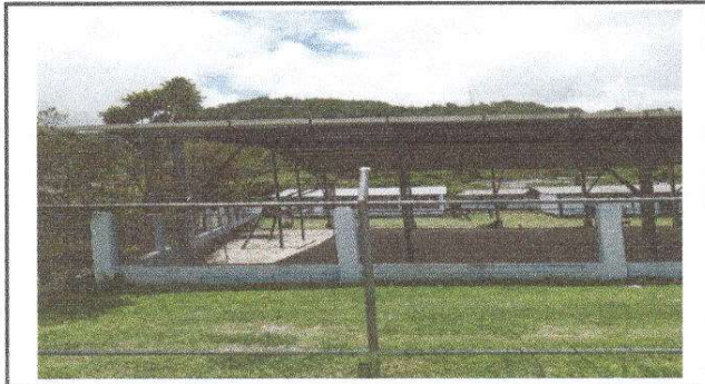
Foto 3: Circulación en mal estado malla rota y tubos oxidados.
