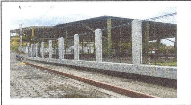
Foto 1: Circulación en mal estado, malla rota y tubos doblados.
