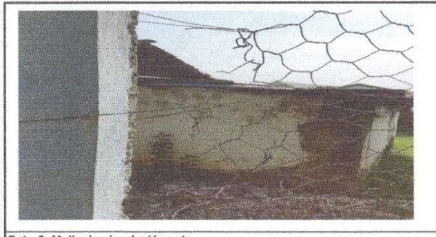
Foto 5: Malla de circulación rota.
